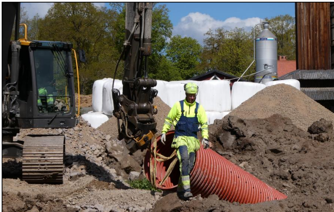
Ola och hans kollegor på Vimmerby Energi & Miljö bygger ny reningsanläggning för avloppsvattnet i Toverum by. Här används en grävmaskin som har en räckvidd på 21 meter. För att åtgärda problemet med grundvattnet från 2 meter till 6 meters djup så sänktes nivån tillfälligt. Idag när förbättringen är gjord är det åter normala nivåer och Toverum har ett bra utsläppsresultat.
